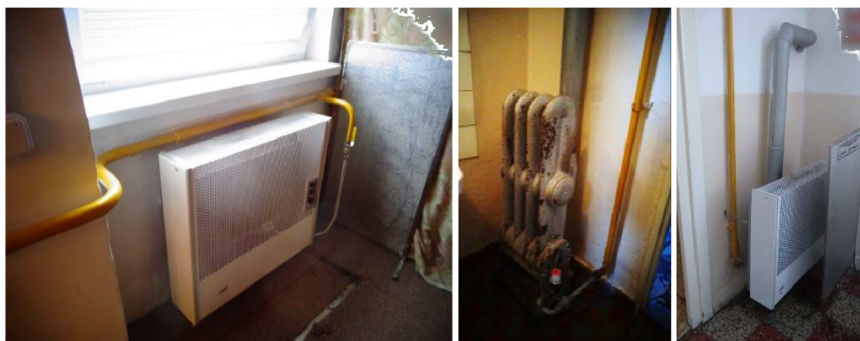
Obr. 8: Plynové gamatky na vykurovanie
