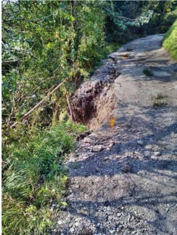
Obr.č.1.1.1. Pohľad na zosunutý okraj chodníka
